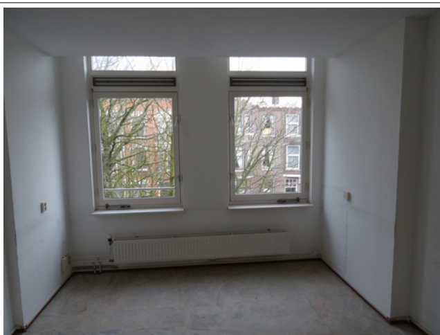
Foto 19: Raamkozijn voorgevel 3 e verd – hout Linker raam sluit moeilijk.
