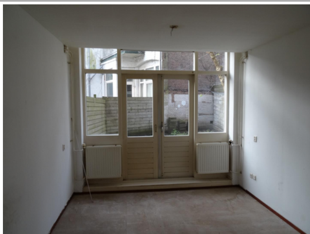
Foto 11: Raamkozijnen achtergevel souterrain/bg - hout
