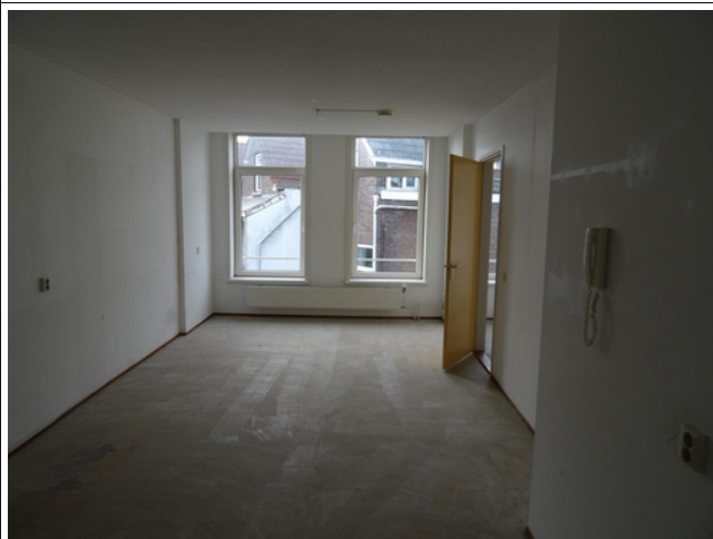
Foto 20: Raamkozijn achtergevel 3 e verd – kunststof Ramen vallen vanzelf open als deze van het slot zijn afgehaald.
