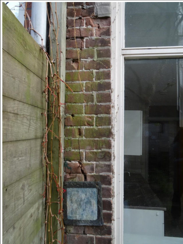
Foto 6: Close-up foto scheuren penant t.h.v. bouwmuur nr 50/52
