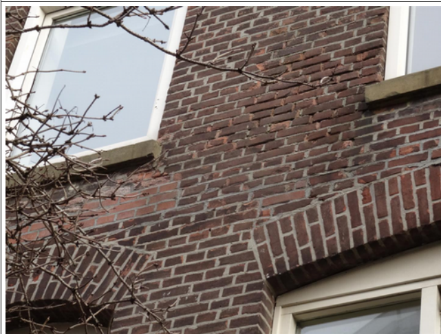
Foto 9: Close-up hersteld metselwerk brostkering 2 e verdieping en slecht metselwerk in penant tussen raamkozijnen
