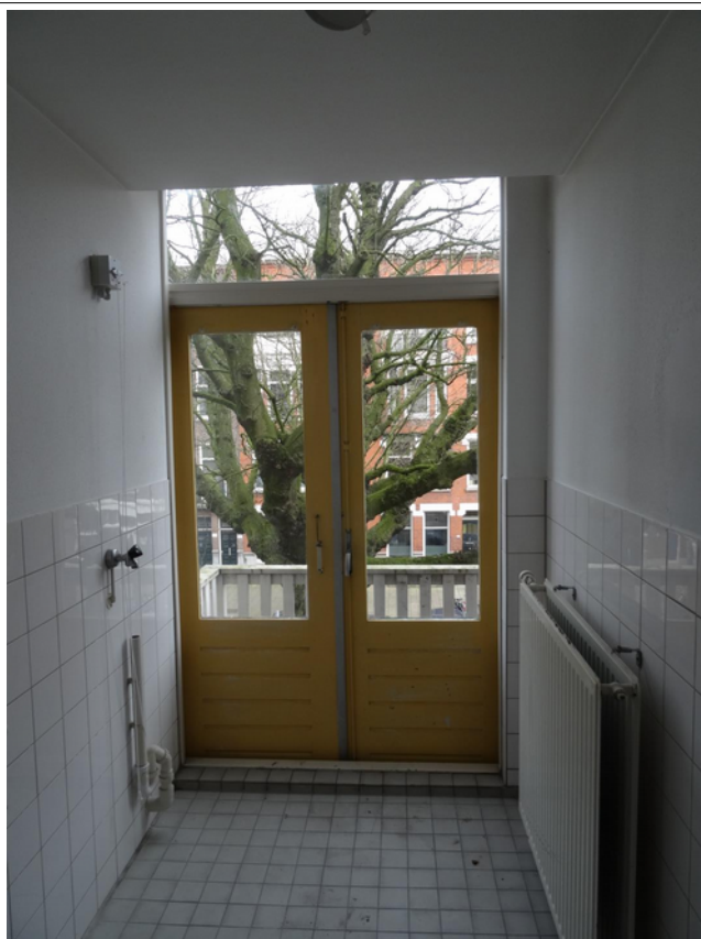
Foto 17: Deur balkon 2° verdieping – hout Deur valt vanzelf open na afhalen slot
