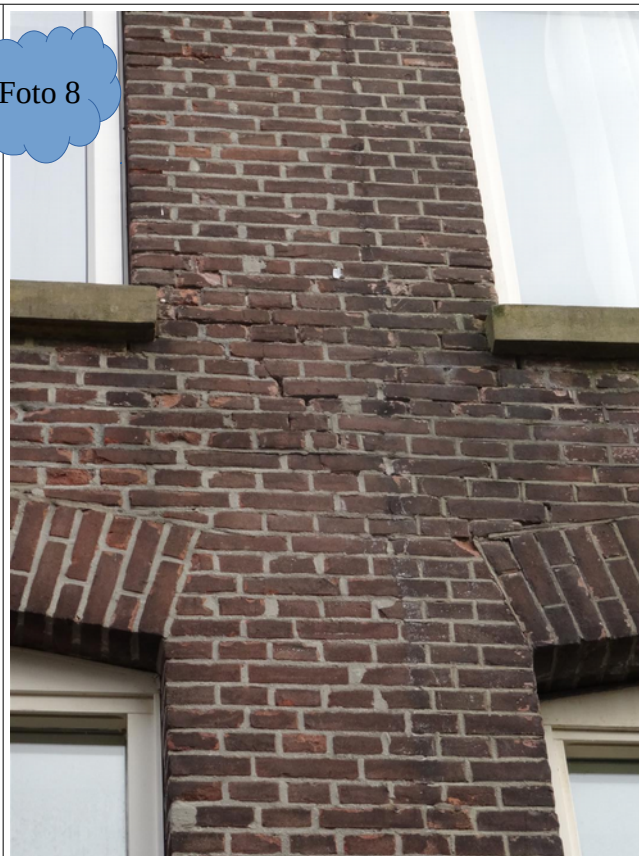
Foto 8: Close-up scheurvorming + slecht voegwerk t.h.v. bouwmuur nr 48/50
