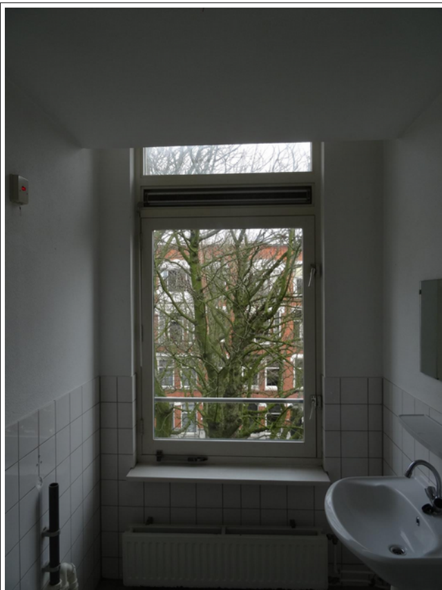
Foto 18: Raamkozijn voorgevel 3 e verd - hout
