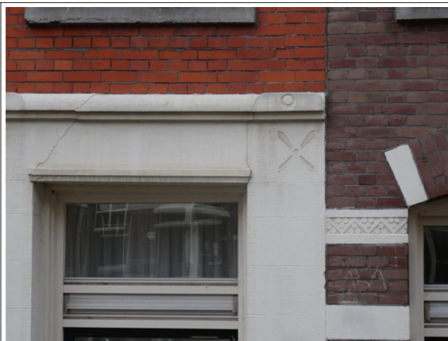
Foto 3: Close-up scheurvorming boven raam souterrain/begane grond nr 48
